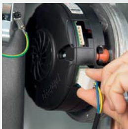
Disconnessione elettrica ventilatore
