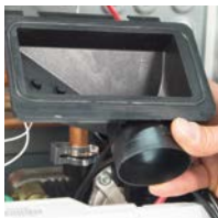
Ispezione raccolta condensa
