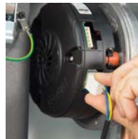
Disconnessione elettrica ventilatore
